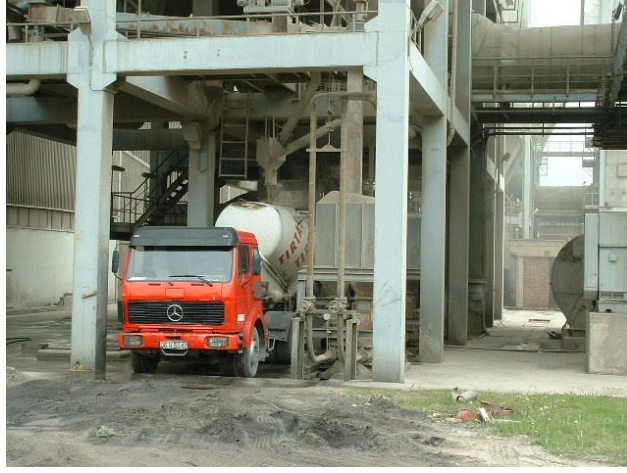
Şekil 1. Çatalağzı termik santrali uçucu kül depolama tesisi
