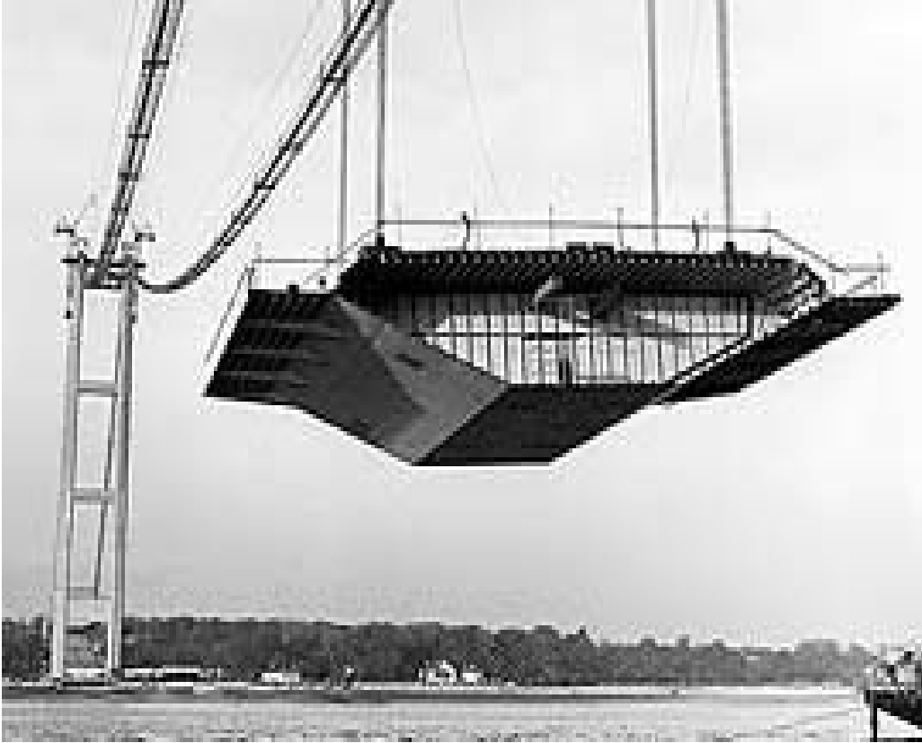
Şekil 2.30. Humber Köprüsü ana kablo ve tabliye yapım aşamalarına ait bazı fotoğraflar (URL 11 ve 12, 2010).
