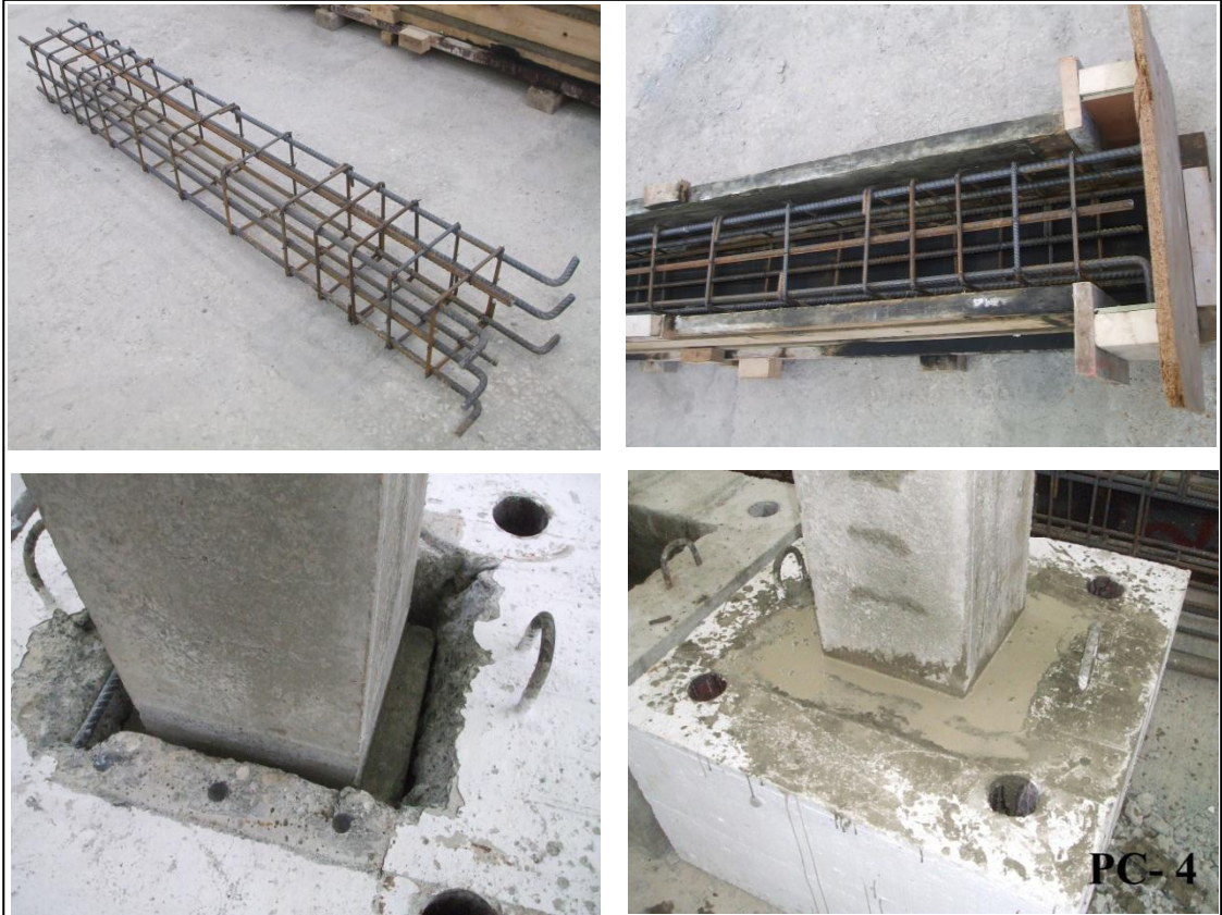
Şekil 2.16. PC-4 nolu deney numunesinin donatısı ve temelle birleştirilmesi
