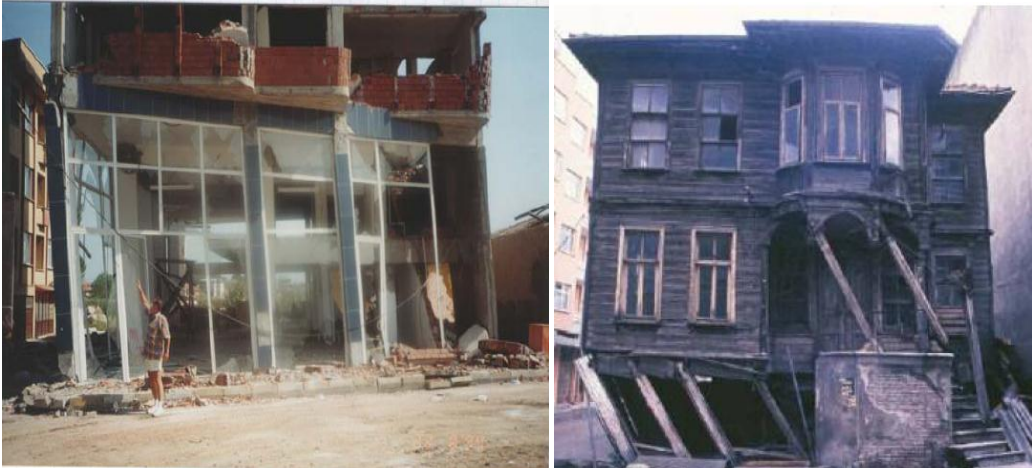
Şekil 1.19. Yumuşak kat düzensizliği nedeniyle hasar görmüş yapılar [4].
