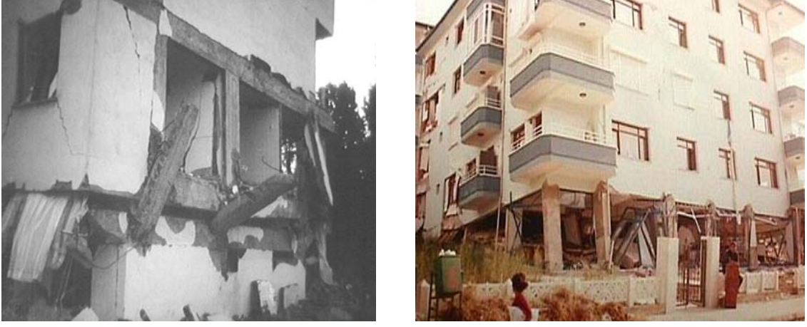
Şekil 14. Yumuşak kat oluşumundan dolayı meydana gelen yapısal hasarlar
