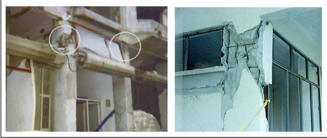
Şekil 17. Kısa kolon oluşumundan dolayı hasar görmüş yapılar
