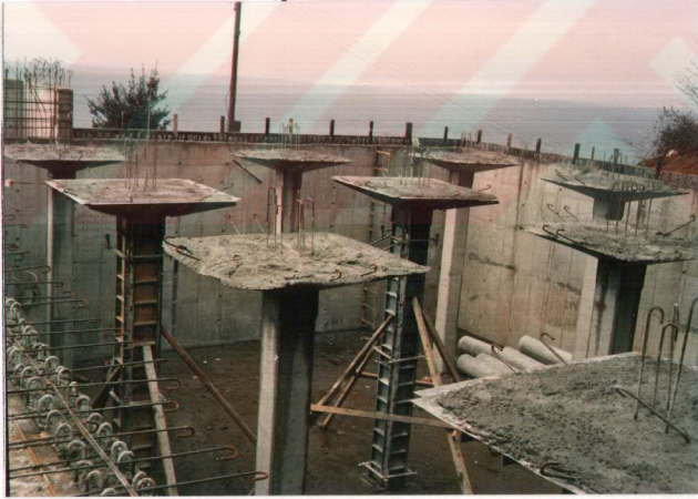
b) Tavan plağının mantar döşeme olarak yapılması nedeniyle depo içinde teşkil edilen kolonlar
