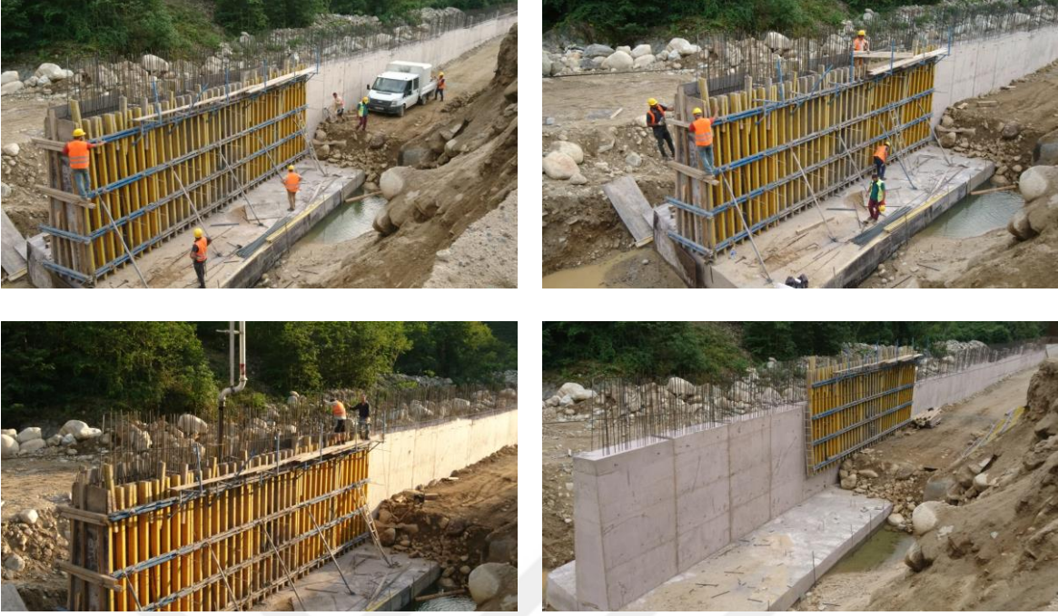
Şekil 11. Perde betonunun dökülmesi
