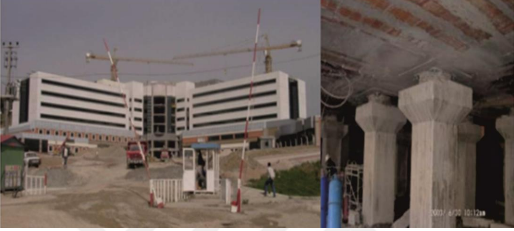
Şekil 1.12. Kocaeli hastanesi sismik izolatör uygulaması [65].
