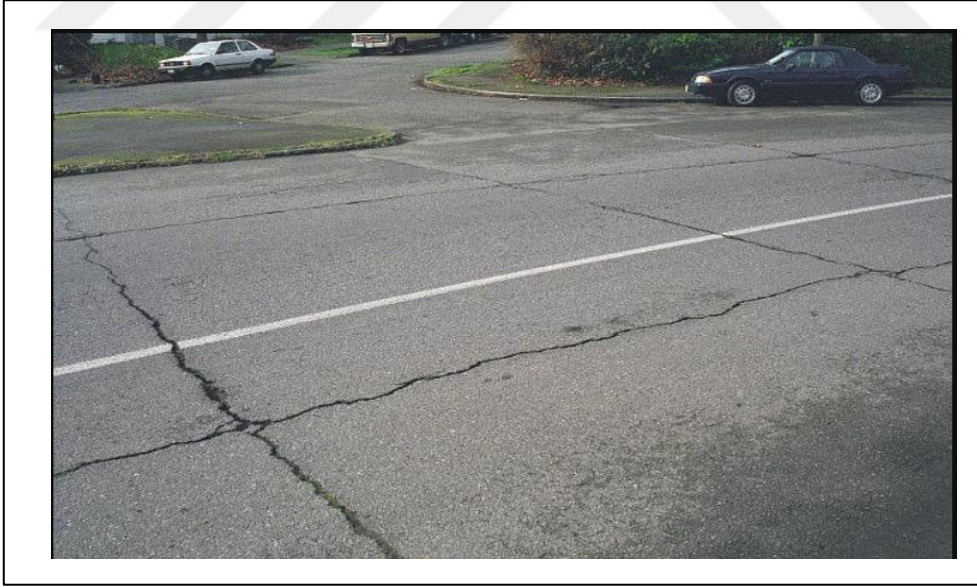
Şekil 1. 3 Beton üstü asfalt kaplamada yansıma çatlakları.
