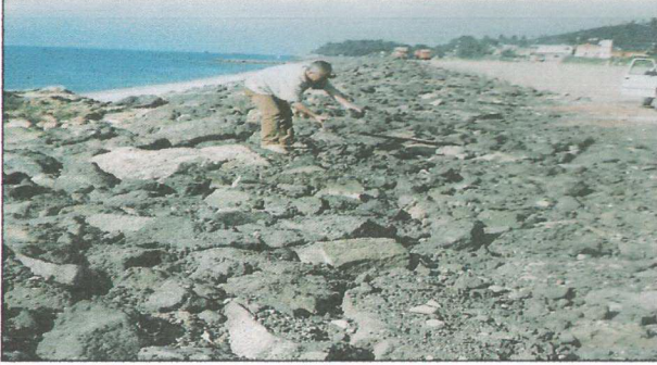
Şekil 2.3.2. Bazı yerlerde tahkimat elle bile parçalanabilmekte (Yılğın Köyü)
