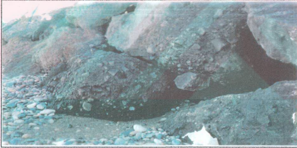
Şekil 2.3.1. Tahkimat bazı yerlerde kendiliğinden parçalanmakta
