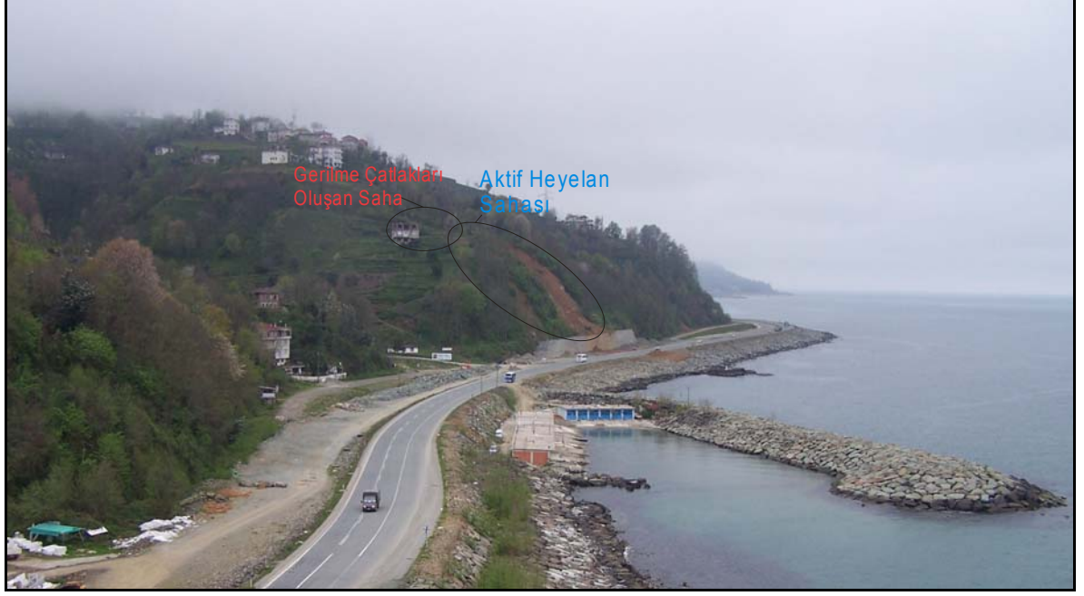
Şekil 26. Yolun sağ yarma şevinde oluşan ve geriye doğru ilerleme potansiyeli olan heyelan sahasının devlet karayoluna göre konumu
