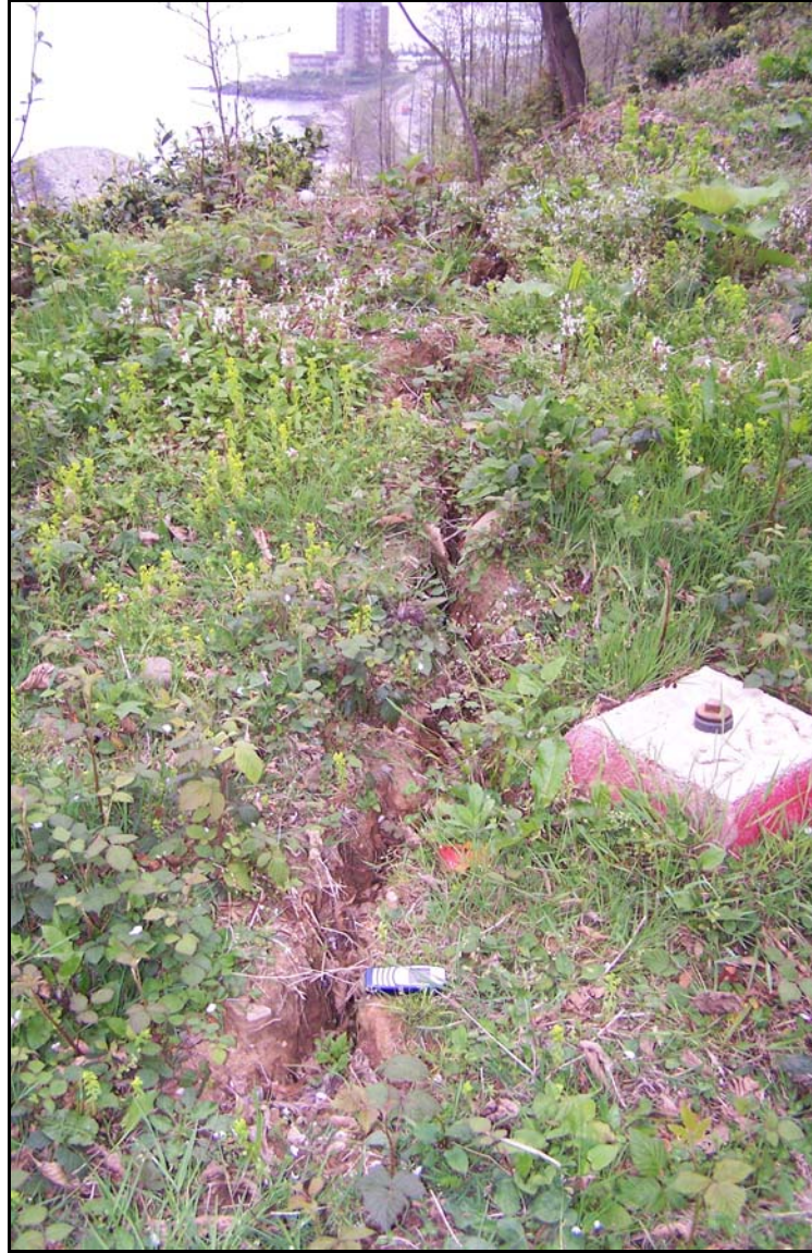
Şekil 29. Heyelanlı sahanın üst kısmındaki arazide oluşan ve geriye doğru gelişen gerilme çatlakları
