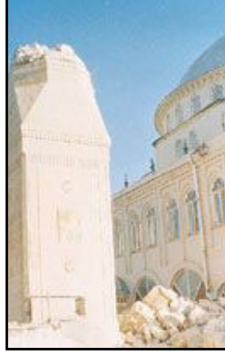
Şekil 1.5. İçel'in Erdemli ilçesinde fırtına nedeniyle yıkılan minarelerden birisi (URL-10, 2006).
