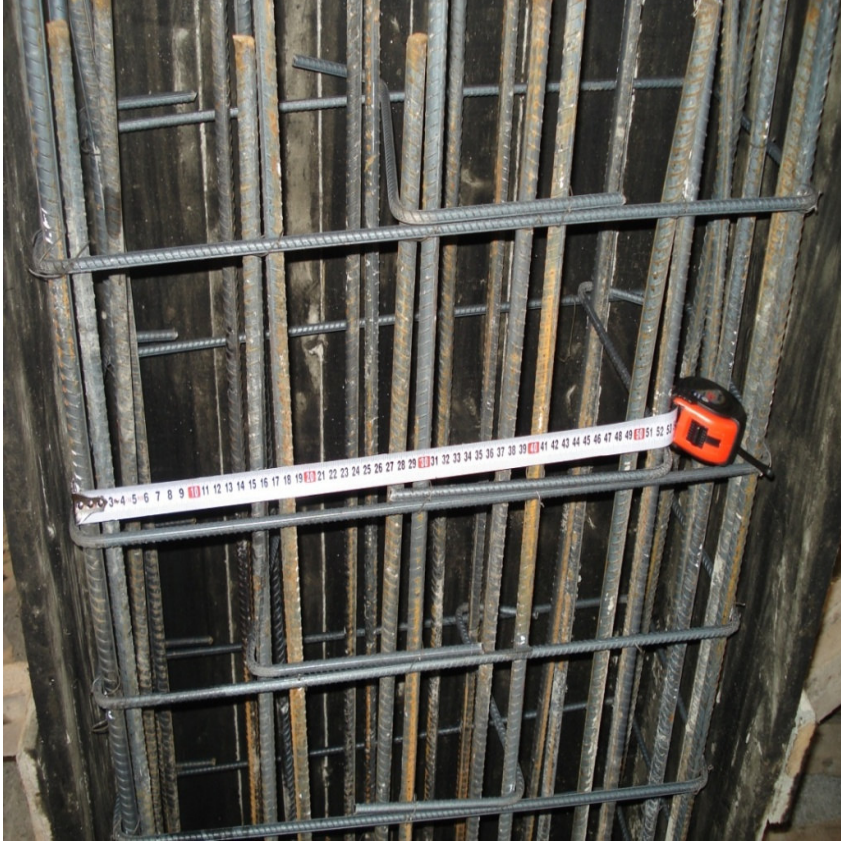
Şekil 2.4. Kolona yerleştirilen çirozların enine donatı kolları ve/veya çirozları arasındaki mesafeyi azaltmada yetersiz kalması
