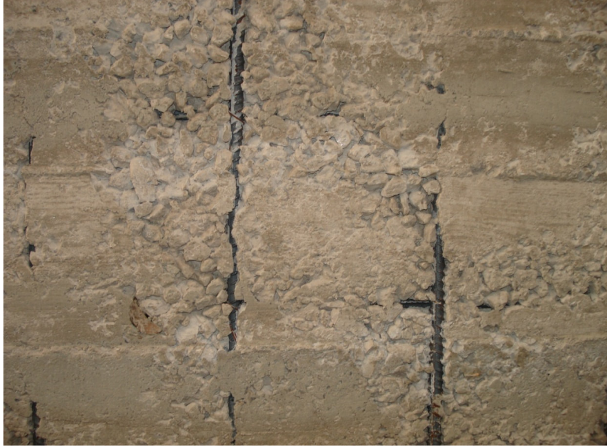
Şekil 2.21. Döşemelerde minimum net beton örtüsü şartına uyulmaması
