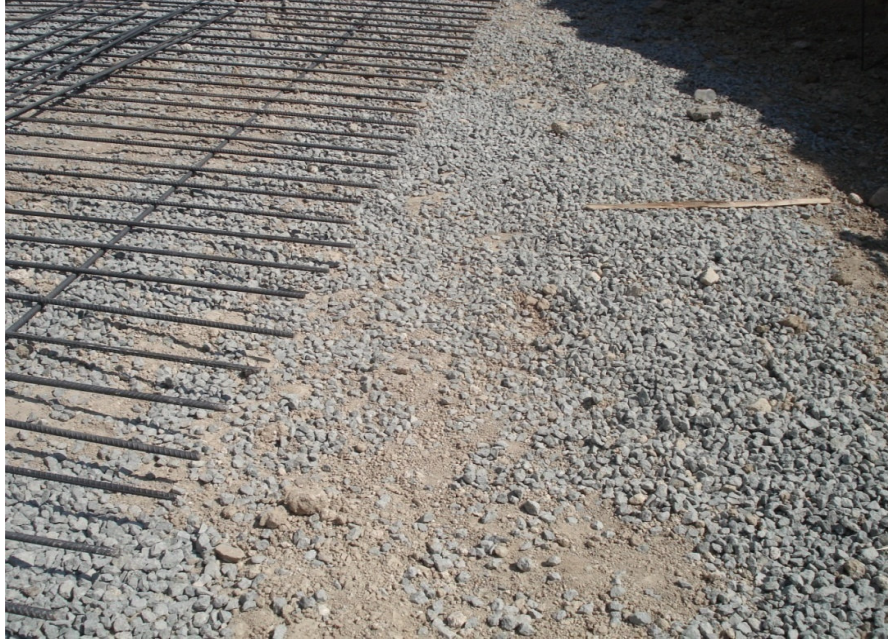
Şekil 2.30. Temelde net beton örtüsü kalınlığı şartına uyulmaması
