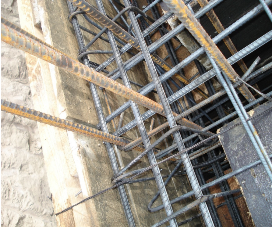
Şekil 2.14. Kenar kolonlara bileşen kirişlerin boyuna donatılarının kolon içerisine 90 derece kıvrılması ile ilgili şarta uyulmaması
