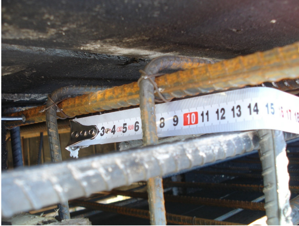
Şekil 2.15. Kolon içerisine uzatılması gereken minimum kiriş boyuna donatısı uzunluğu şartına uyulmaması
