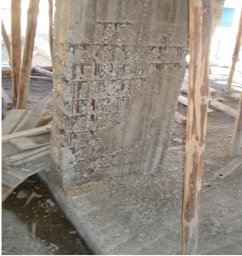
Şekil 2.9. Kolonlarda net beton örtüsü şartına uyulmaması
