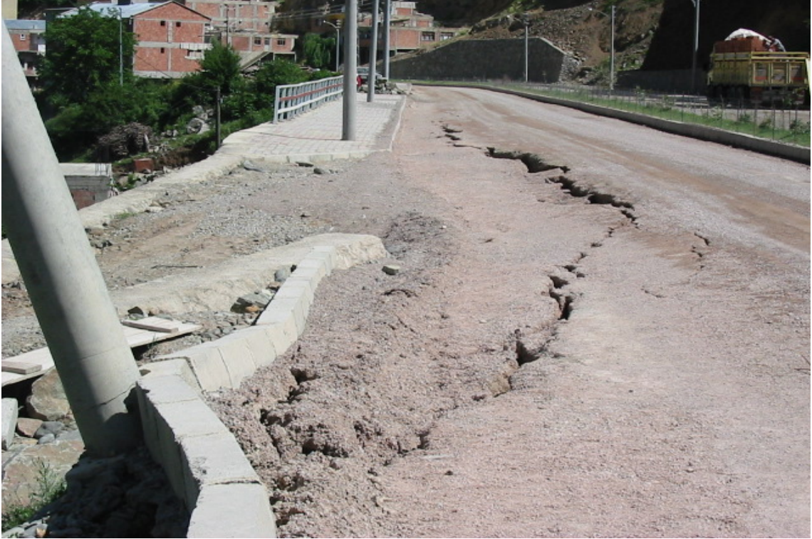
Şekil 26. Karayolunun baraj gölü tarafında yaklaşık 100m uzunlukta yay şeklinde oluşan çatlak
