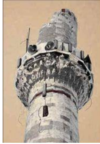
Őekil 1.11. Petek b lgesinde meydana gelen hasar (CIAI’S, 2006)
