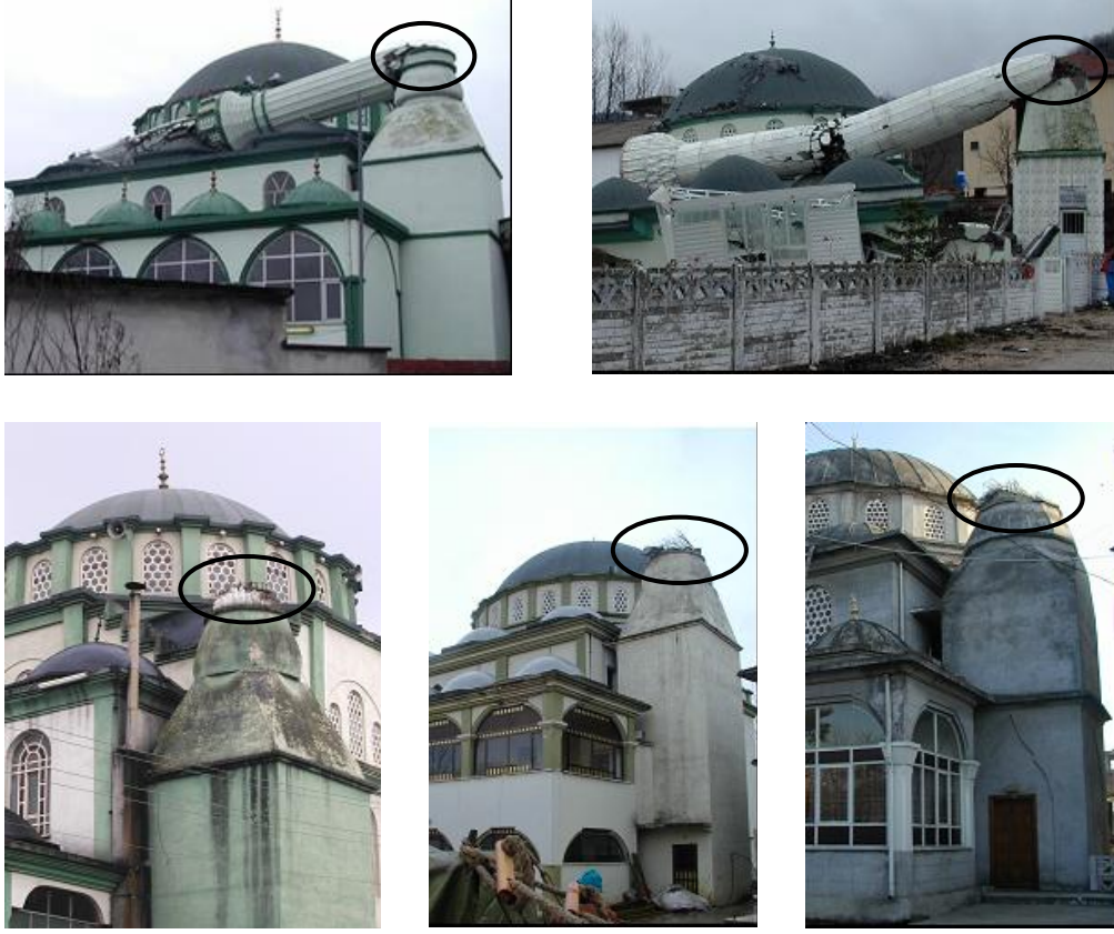
Şekil 1.14. Betonarme minarelerde gövdenin altında meydana gelen hasarlar (Sezen vd, 2008).
