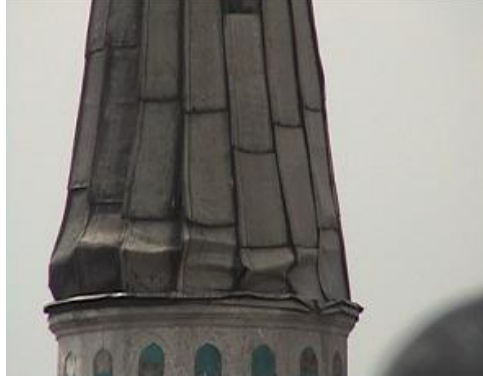
Şekil 1.10. 1999 depremlerinde k lah kısmında meydana gelen hasar (SDR, 2005)
