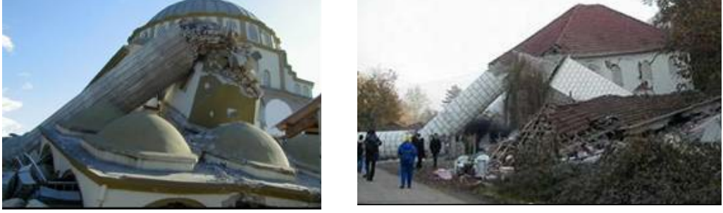
Şekil 1.17. Kaide hasarları (Sezen vd, 2008).
