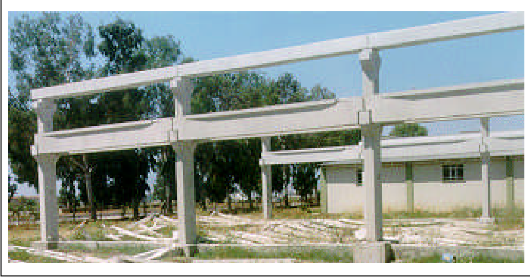
Şekil 96. Kirişlerin ayakta kalması bazılarının yere düştüğü yapı
