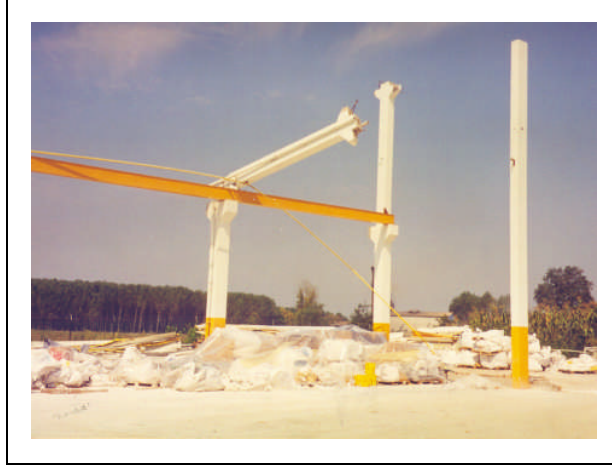
Şekil 98. Prefabrike kolon ortasında hasar
