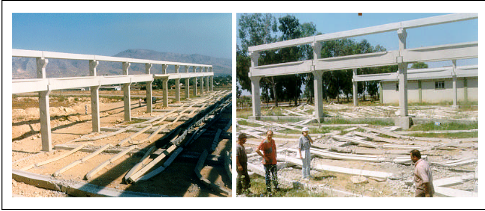
Şekil 90. Prefabrike çerçeveli yapı sistemde çatı kirişlerinin yıkılması [21]
