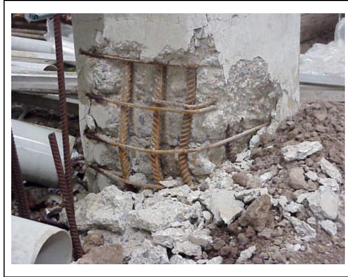
Şekil 97. Kolon tabanındaki mafsallaşma
