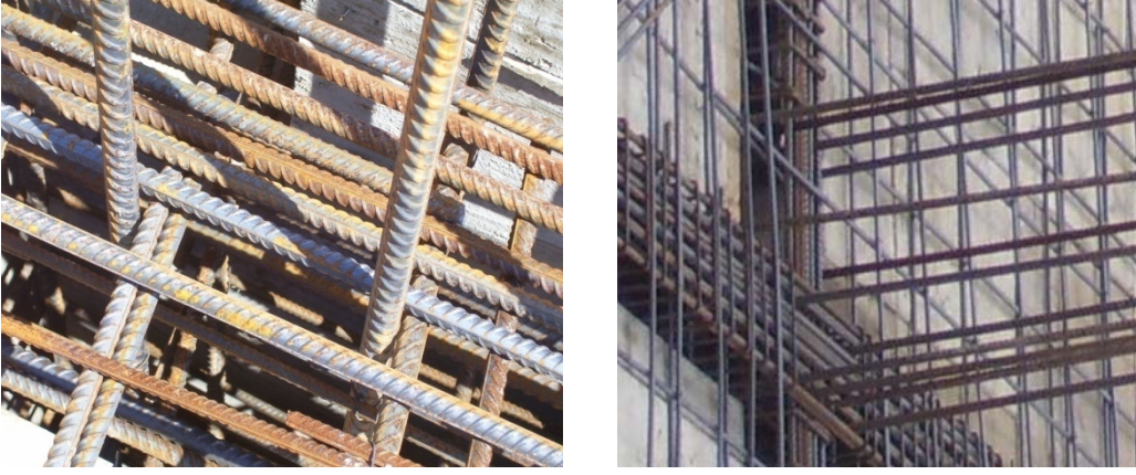
Şekil 2.9. Kirişlerde boyuna donatı çubukları arasındaki mesafenin TS 500 (2000)'de verilen şartları sağlamaması durumuna ait örnekler
