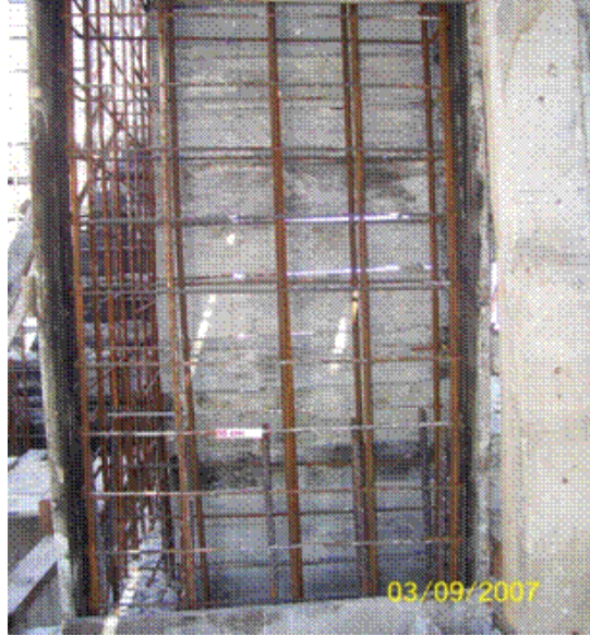
Şekil 2.5. Kolonda bindirme boyu koşuluna uyulmaması durumuna bir örnek
