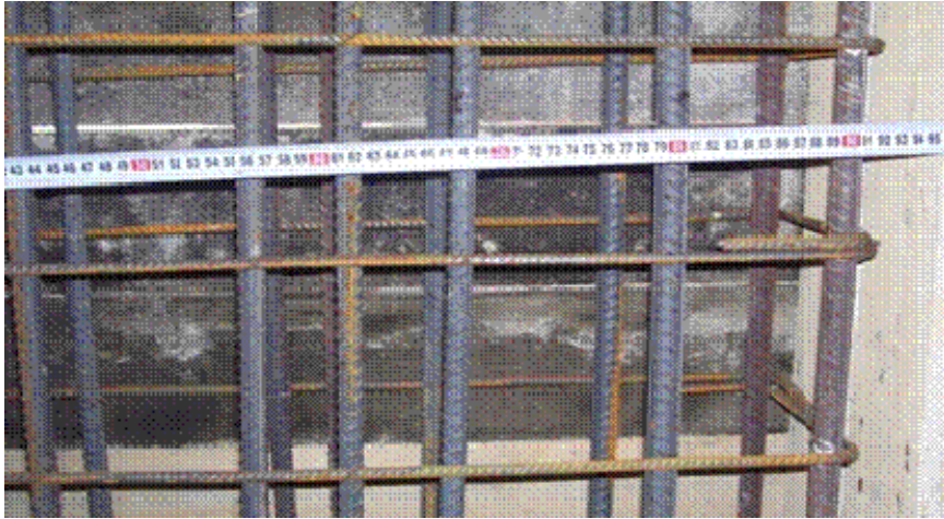
Şekil 2.4. Enine donatı kolları ve/veya çirozlar arasındaki en büyük mesafe şartına uyulmaması durumuna bir örnek
