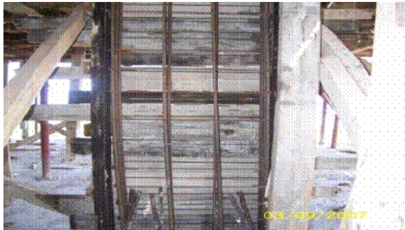
Şekil 2.7. Kolonlarda sarılma ve orta bölgede kullanılan enine donatı aralıklarının uygun olması durumuna bir örnek
