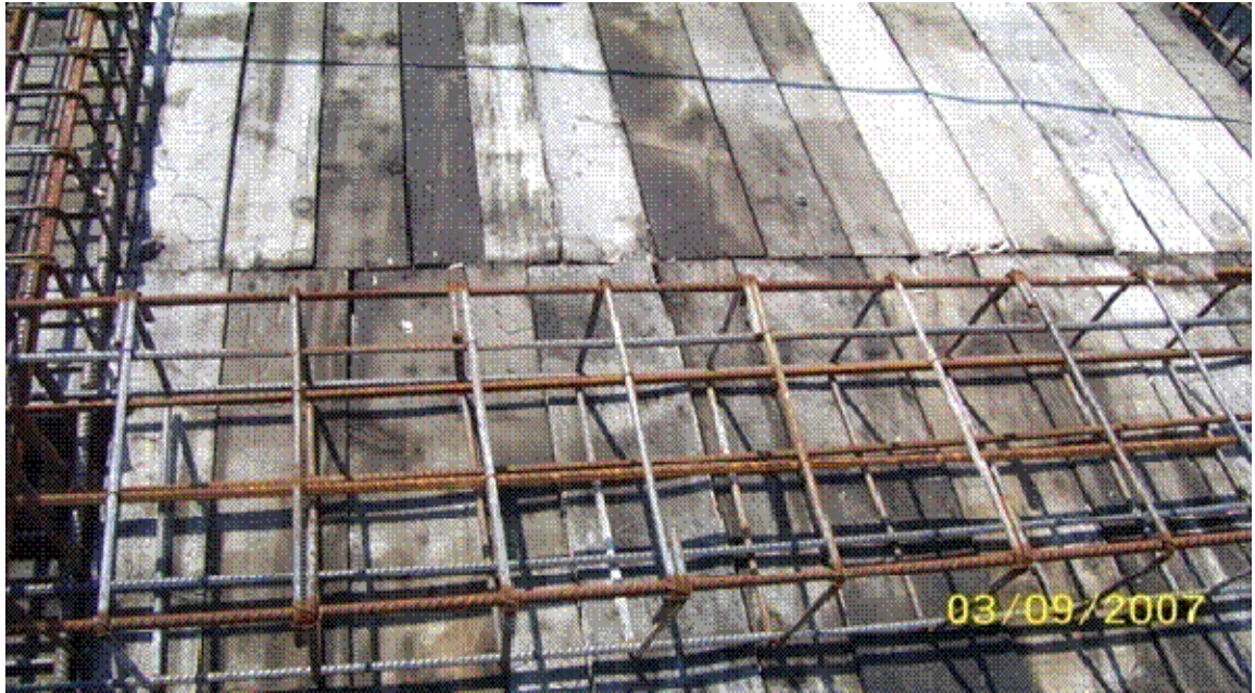
Şekil 2.14. Kirişlerin sarılma ve orta bölgelerinde kullanılan enine donatı aralıklarının uygun olmaması durumuna ait örnekler
