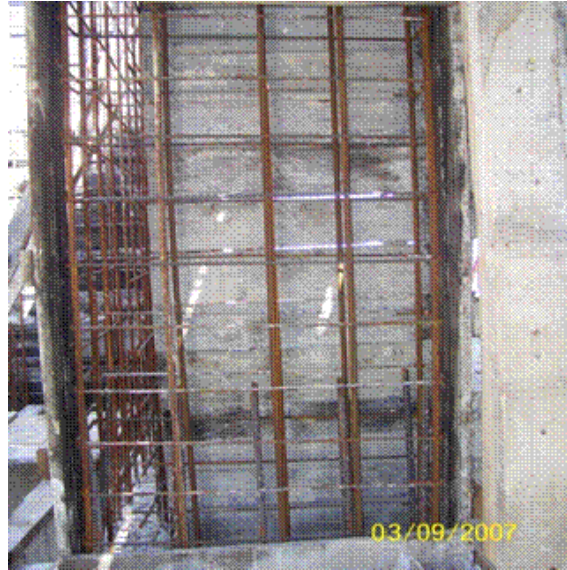
Şekil 2.6. Kolonlarda sarılma bölgesi uzunluğu ile ilgili şartlara uyulmaması durumuna bir örnek
