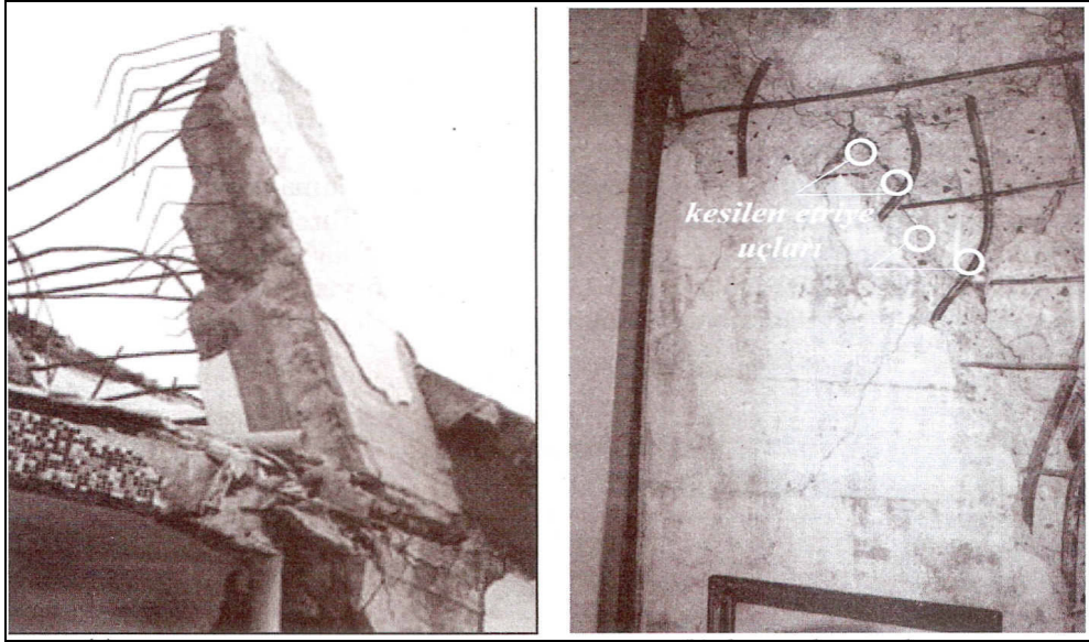
a- depremde etriyelerin kolayca açılması b- depremde etriyelerin kesilene kadar çalışması
