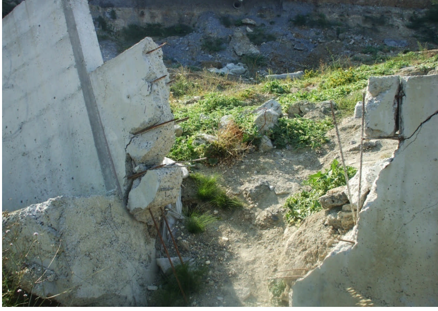
Şekil 35. Heyelan sonrasında yıkılan istinat duvarları
