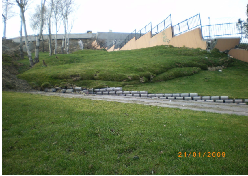
Şekil 33. Heyelan esnasında yıkılan perde duvarlar
