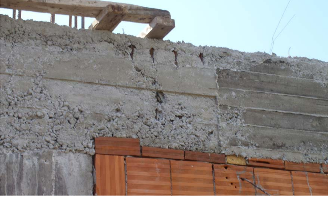
Şekil 2.15. Kirişlerde net beton örtüsü kalınlığının sağlanmaması durumu
