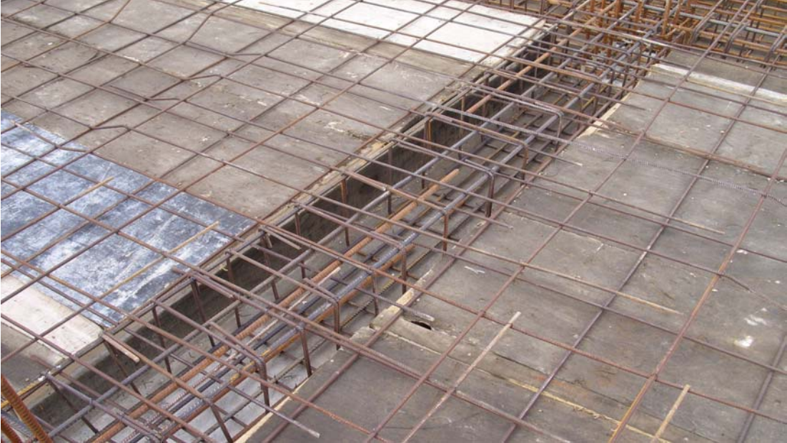
Şekil 2.19. İki doğrultuda çalışan kirişli döşemelerde kısa kenar doğrultusunda yerleştirilen donatı aralığı ile ilgili verilen şartlara uyulmaması durumu
