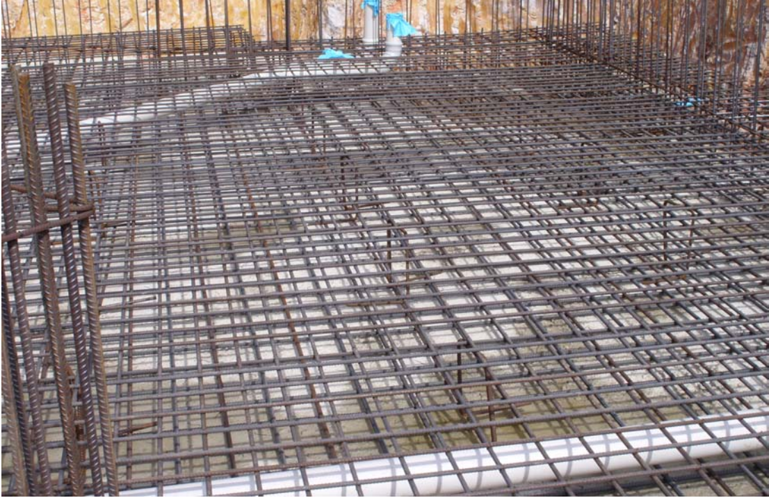
Şekil 2.26. Temelerde net beton örtüsü kalınlığı şartının sağlanmaması durumu
