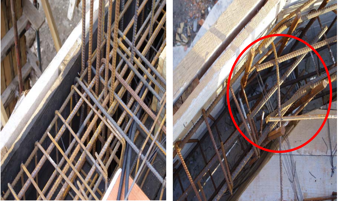
Şekil 2.13. Kirişlerde kenetlenme boyunun yetersiz kalması durumuna ait örnekler
