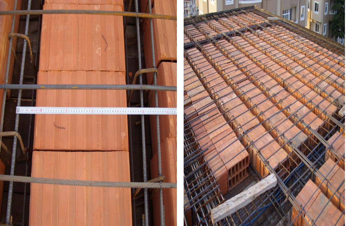
Şekil 2.21. Dişli döşemelerde dağıtma donatısı aralığı ile ilgili şarta uyulmaması durumu
