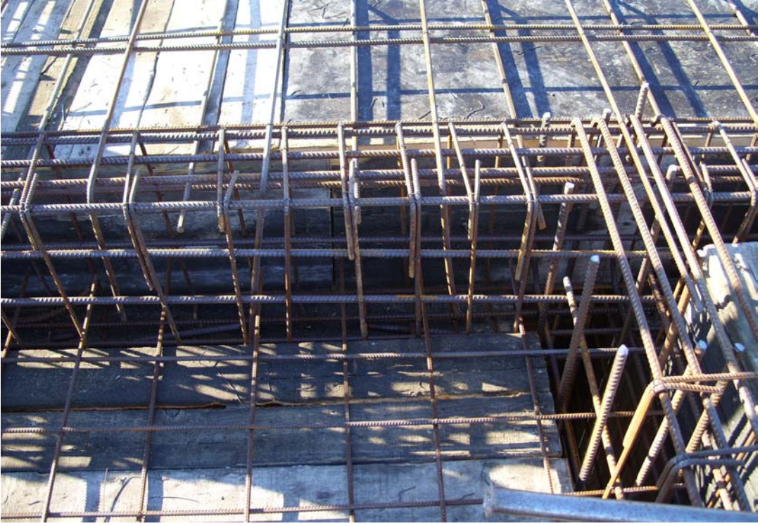
Şekil 2.16. Kuşatılmamış kolon–kiriş bölgelerinde donatı ile ilgili verilen şartlara uyulmaması durumu
