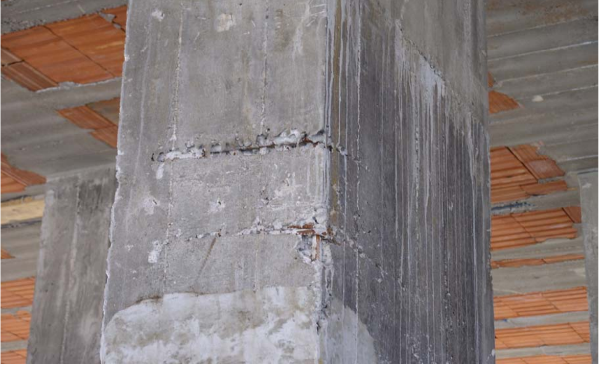
Şekil 2.9. Kolonlarda net beton örtüsü şartına uyulmaması durumu
