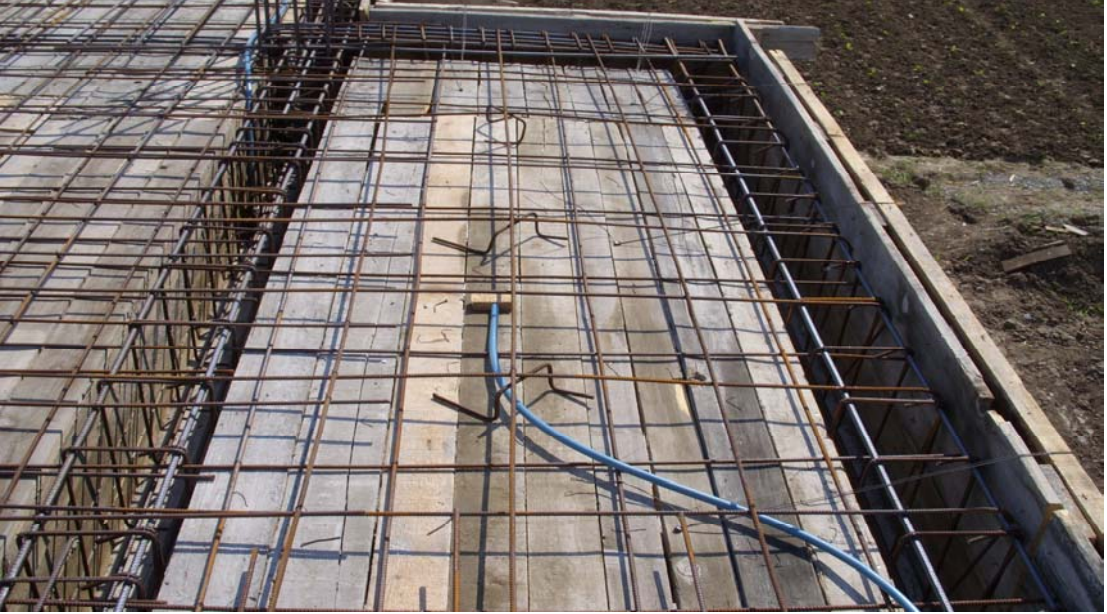
Şekil 2.20. Tek doğrultuda çalışan döşemelerde çekme donatısı aralığı ile ilgili verilen şartlara uyulmaması durumu
