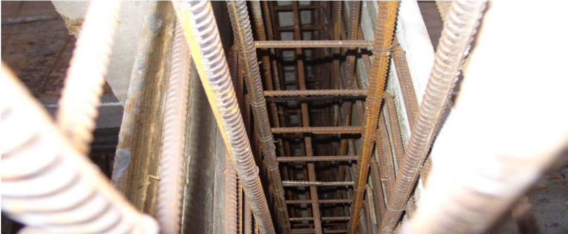
Şekil 2.23. Betonarme perdelerde çiroz kullanılmaması ve uygun olmaması durumu
