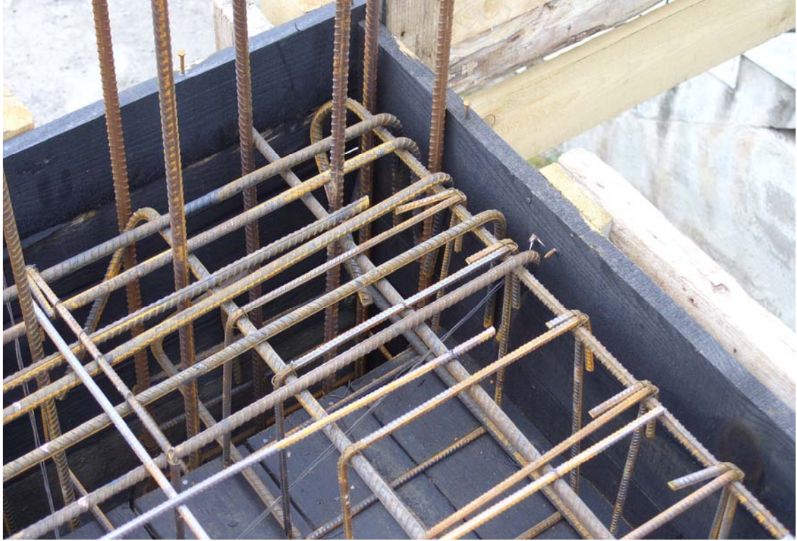
Şekil 2.11. Kenar kolonlara birleşen kirişlerin boyuna donatılarının kolon içerisine 90 derece kırılması ile ilgili şarta uyulmaması durumu
