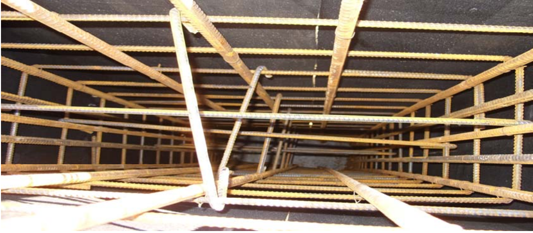
Şekil 2.5. Kolona yerleştirilen çirozların eninedonatı kolları ve/veya çirozları arasındaki mesafeyi azaltmada yetersiz kalması durumu
