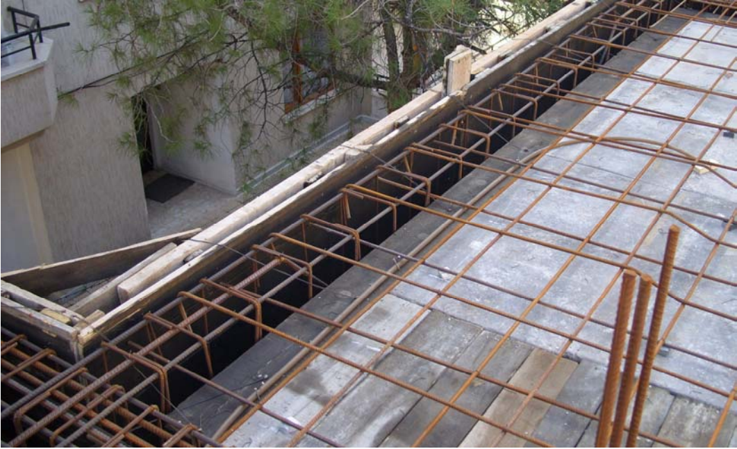
Şekil 2.14. Kirişlerin sarılma ve orta bölgelerinde kullanılan enine donatı aralıklarının uygun olmaması durumu
