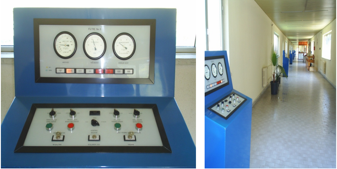
Şekil 7. Filtrasyon Geri Yıkama Ünitesi
