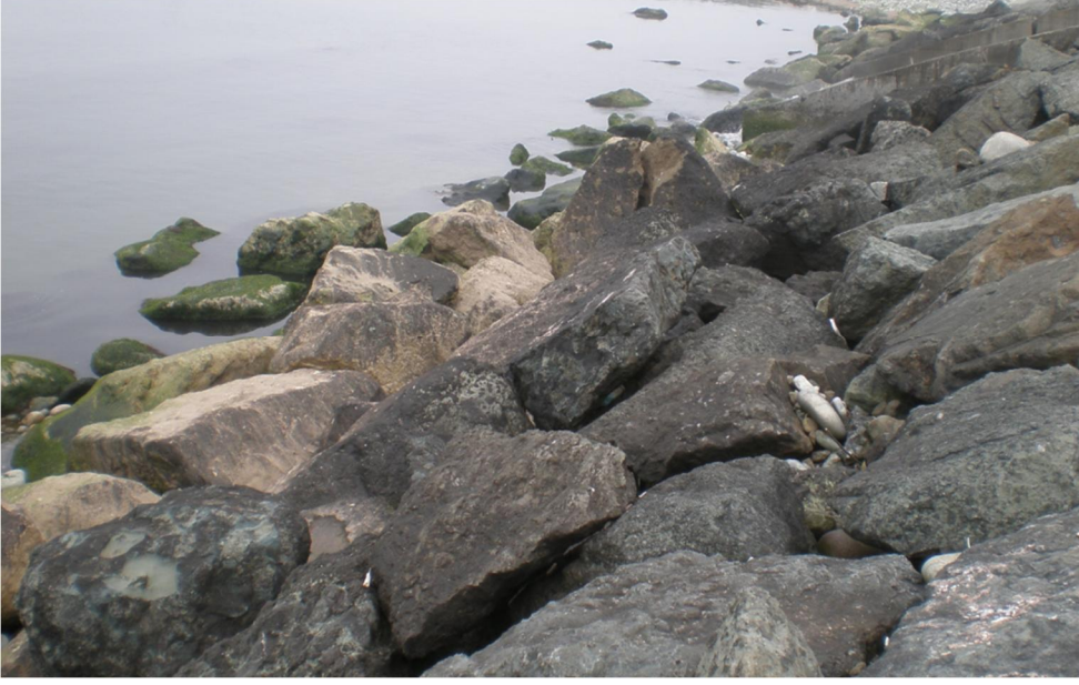
Şekil 3.3. İyidere – Of arası hasar görmüş kıyı tahkimatı
