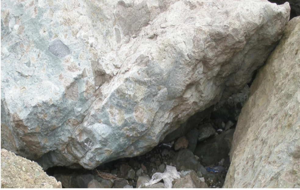
Şekil 3.2. İyidere – Of arası kıyı tahkimatında filtre tabakası uygulama hatası
