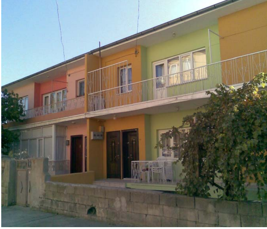
Şekil 2.17 Duvar boşluk oranı fazla olan bina
