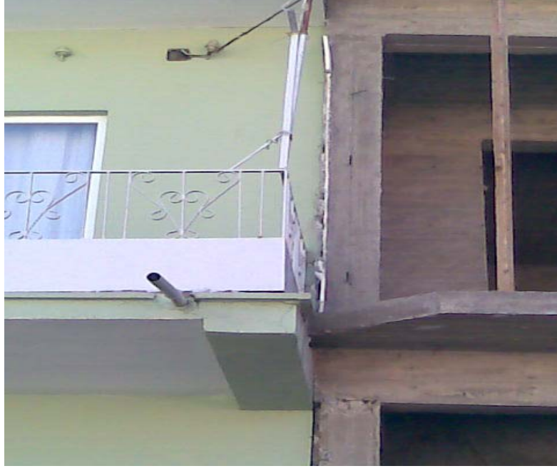
Şekil 2.22 Çarpışma etkisi olan yığma-betonarme bina
