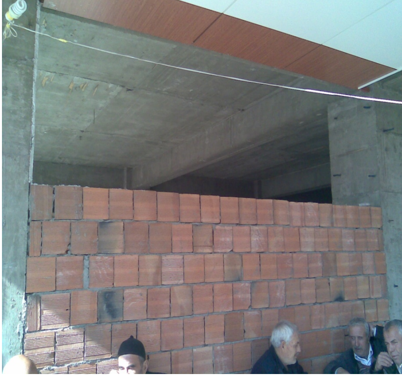
Şekil 2.10. Kısa kolon oluşumuna sebep olan duvar.
