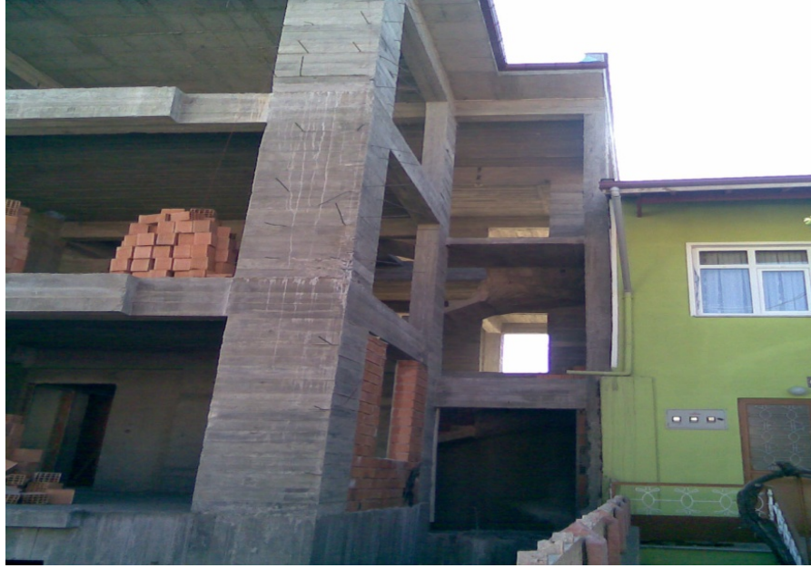
Şekil 2.23 Yığma binanın bitişiğinde yapılan betonarme yapı ile çarpışma etkisi
