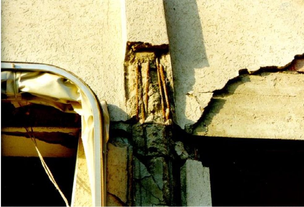
Şekil 1.3. Kocaeli depremi sonrası ağır bina hafif bina çarpışması sonucu hafif binada görülen bölgesel çatlaklar (URL – 1, 2010)
