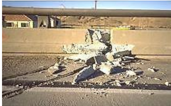
Şekil 1.15. 1994 Northridge depremi sırasında genişleme derzi bırakılmış köprü tabliyesindeki çarpışma sonucu oluşan hasarlar (Muthukumar, 2003)
