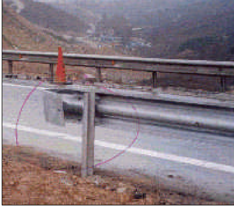
Şekil 93. Uç parçası havada bırakılmış ve araç çarpması sonucu aracın otokorkuluk sistemine saplanma riski yüksek olan otokorkuluk sistemi
