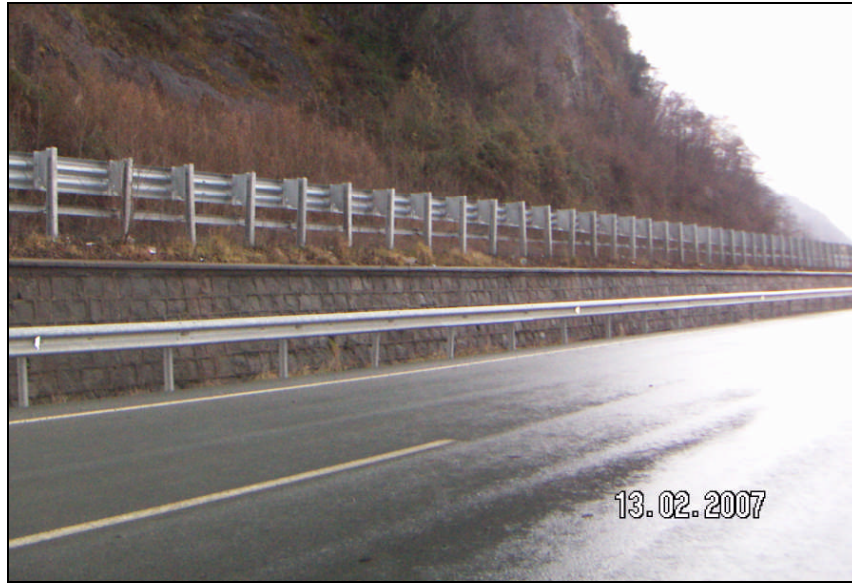
Şekil 92. Beton taş duvara araçların çarpmaması için inşa edilen çelik otokorkuluk (Hopa, 2007)
