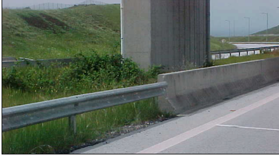
Şekil 95. Yetersiz çelik dikeç kullanımı ve bağlantı eksikliği ile ortaya çıkan zayıf geçiş bölgesi
