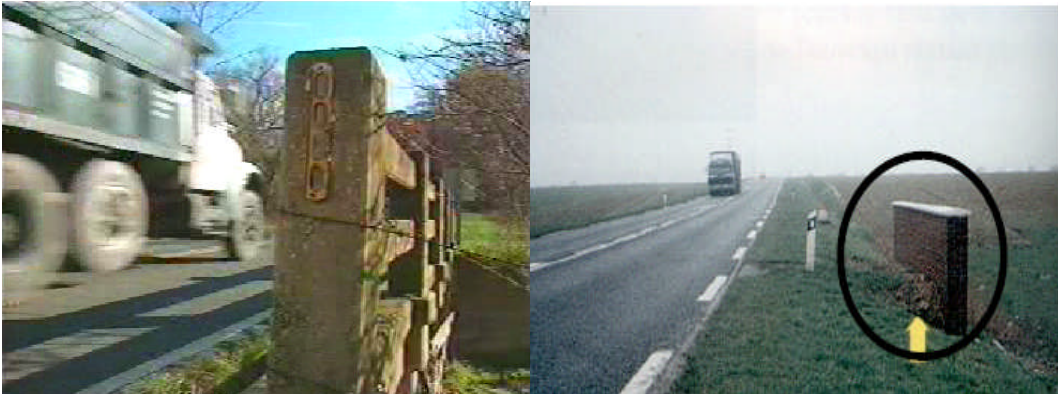
Şekil 14. Korunmamış köprü korkulukları
