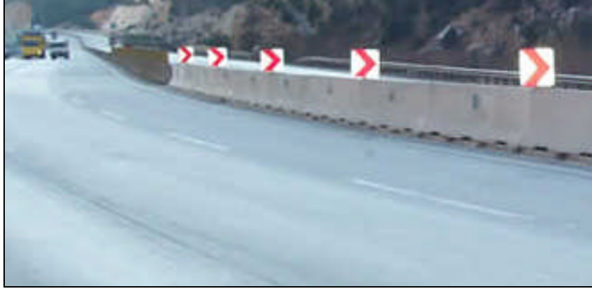
Şekil 90. Tamamen rijit bir sistem olan ve yanal deformasyonu olmayan beton otokorkuluk
