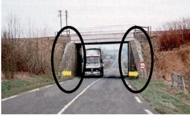
Şekil 15. Korumasız köprü duvarları
